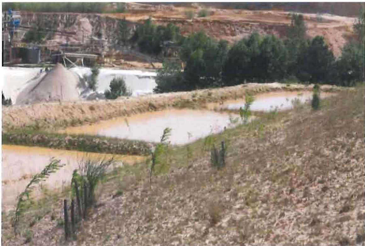
Alvéoles en bas du secteur 3 encore en eau dix jours après la pluie.
